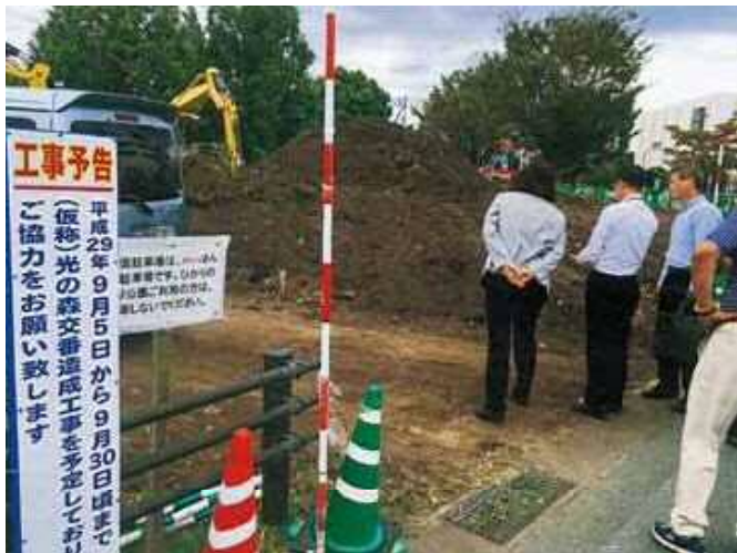
平成30年4月1日開所予定の(仮称)光の森交番の工事状況視察
