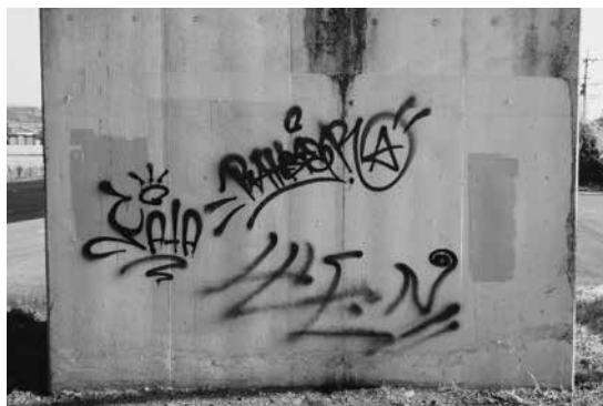
落書きされた橋脚
