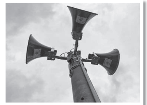
境の松自治会に整備した屋外放送設備
