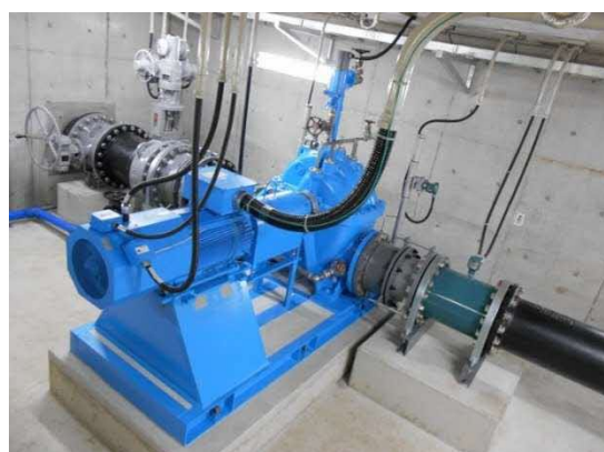
小水力発電（戸島送水場）
