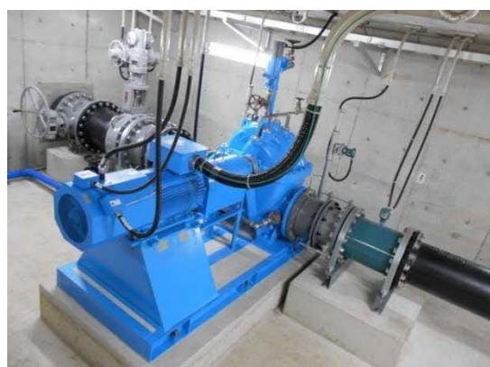
小水力発電 (戸島送水場)
