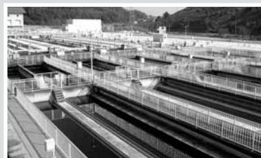
▲熊本北部浄化センター水処理施設 菊陽町内から排出される汚水の最終処理場
