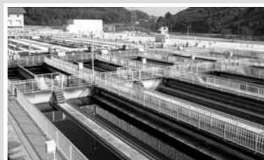
▲熊本北部浄化センター水処理施設 菊陽町内から排出される汚水の最終処理場
