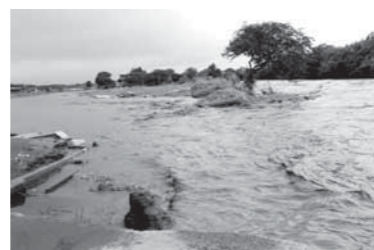
▲7月12日(曲手) 増水した水が白川沿いの道路を壊し、水田の中にもう1本の川をつくっていた。
