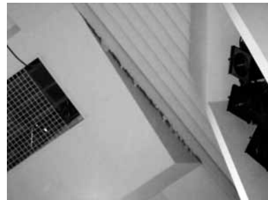
ホール天井の亀裂
