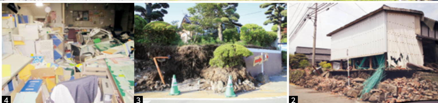
1 家の柱や基礎など全体的に傾いた家屋。住民は避難し、全員無事 2 3 家屋や小屋のブロック塀崩壊 4 役場の事務室内。キャビネットから書類が落下し、足の踏み場のないほど散乱した
