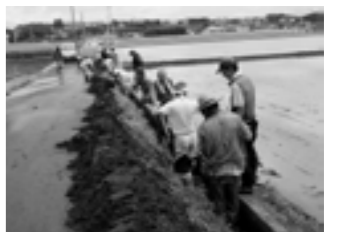
大雨で堆積した土砂の泥上げ
